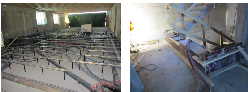
Figur 4.1. Den vänstra bilden visar hur ”stälningarna” till installationsgolvet är utplacerade ovanpå betongbjälklaget (där fastighetsgränsen går). Ovanpå dessa ställningar ska inngolvets monterats. De olika ledningar som behövs för ägarlägenhetens försörjning ligger i utrymmet mellan betongbjälklaget och golvet i lägenheten. Den högra bilden är tagen i trapphuset och visar att trappan slutar i det kommande inngolvets nivå medan betongbjälklaget ligger ca 30 cm därunder. Foto: Thomas Micha, Lantmäterimyndigheten i Växjö kommun.
