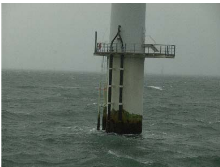
Figur 3 Kabelgenomföringen för ett monopilefundament, Horns rev Foto: Åke Larsson
