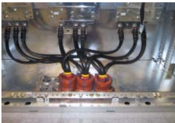
Bild 2-6 Visar ferritringar* som monterats på utgående motorkablar, för att reducera högfrekvent ström. (Bild ABB)
