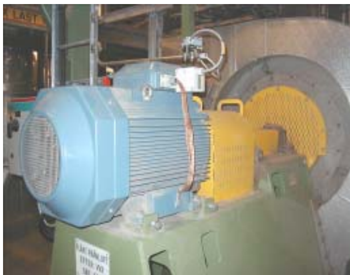
Bild 6-1 Visar den förstärkta jordningen i form av en kopparfläta mellan motorhölje och jordskruven i kopplingslådan på en av motorerna vid värmeåtervinningen, PM8.
