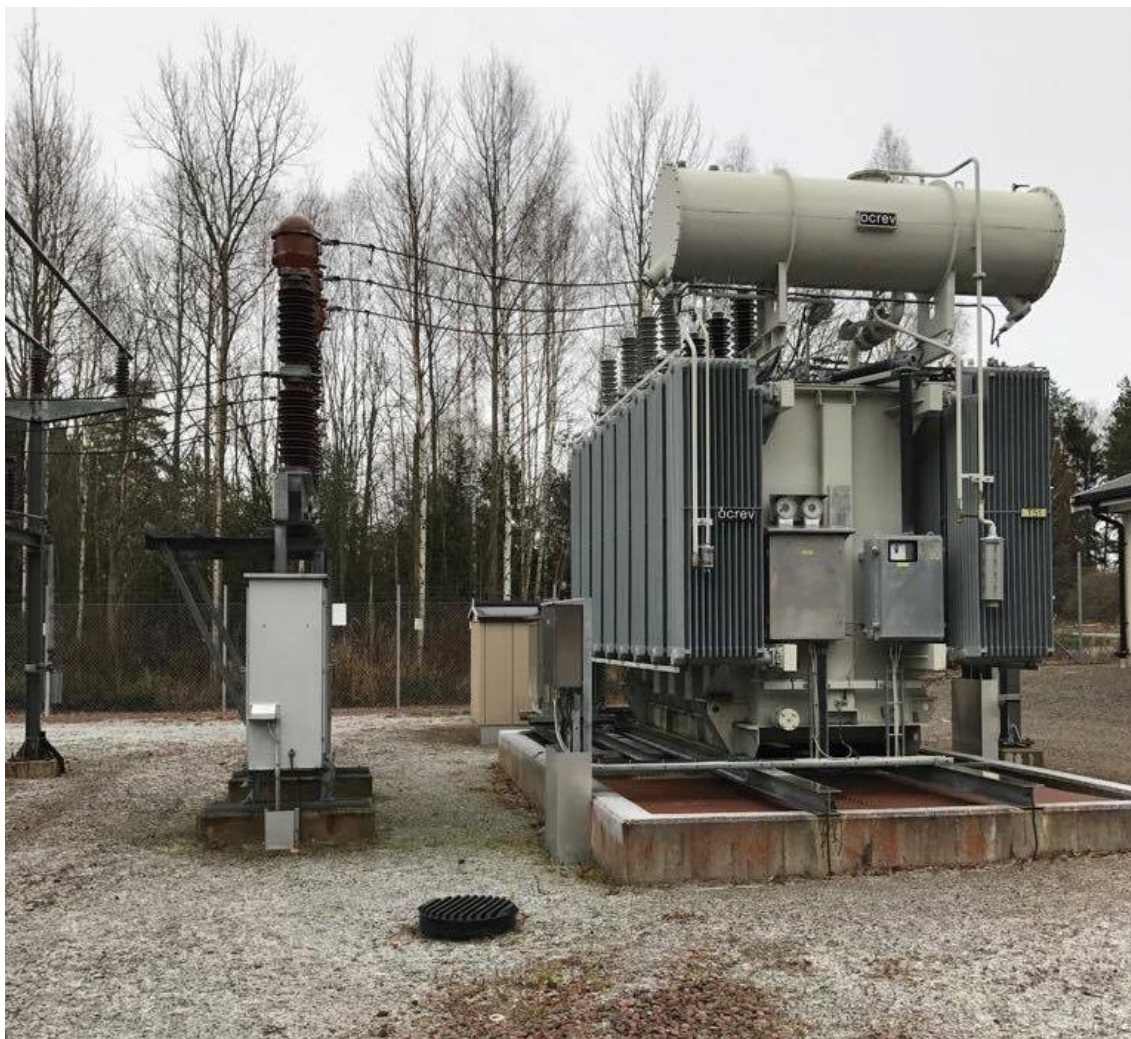
Figur 2.7, Integrerad strömtransformator på ovsidan av krafttransformatorn i ett 50 kV nät.
