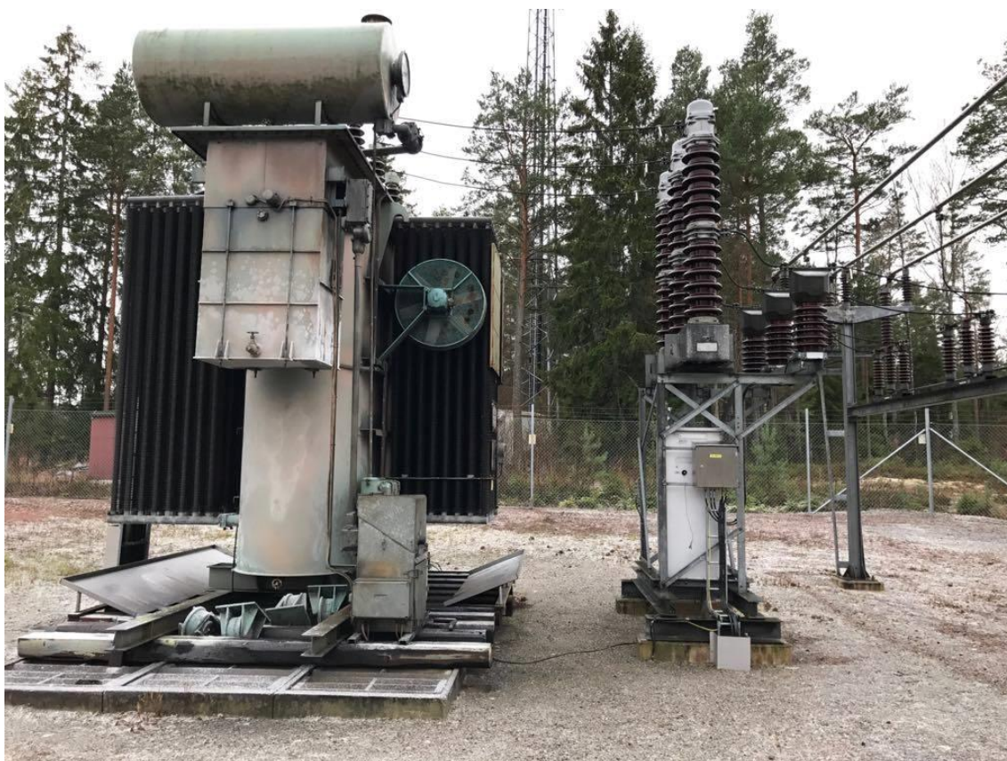
Figur 2.5, Visar en strömtransformator till höger i bild där den sitter på ett stativ i direkt anslutning till ett högspänningsskåp placerat under strömtransformatorn. Kablarna från skåpet går ned i marken och in till kontrollutrustningen
